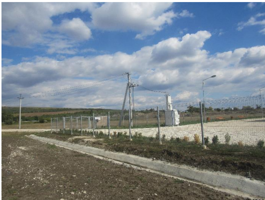
Figura 82. Linia electrică și un transformator deja existent la locația respectivă
